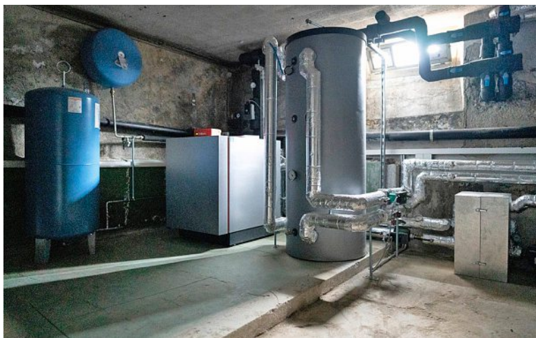
Les nouvelles installations sont parfois mal paramétrées. KEYSTONE
